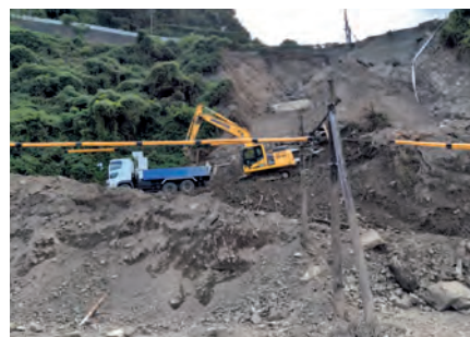
(国) 473号線島田市福用での碎石流出土砂等を撤去
